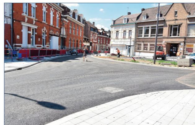
Dernière partie du chantier de la gare pôle d'échanges à l'heure où nous bouclons ce 4 pages : la place Saint-Piat, entièrement réaménagée.
