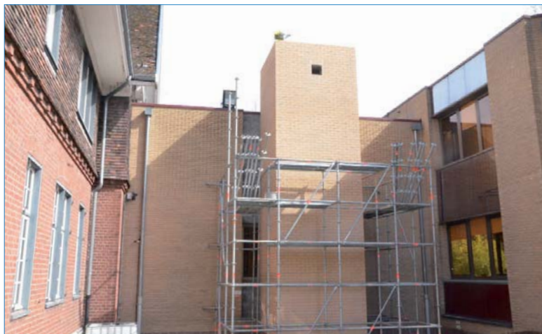
Un ascenseur est en cours de construction à l'Hôtel de Ville pour améliorer l'accessibilité du bâtiment communal aux personnes à mobilité réduite.
